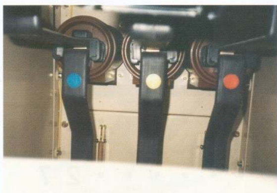
ブスバーの絶縁被覆 (NPN)
