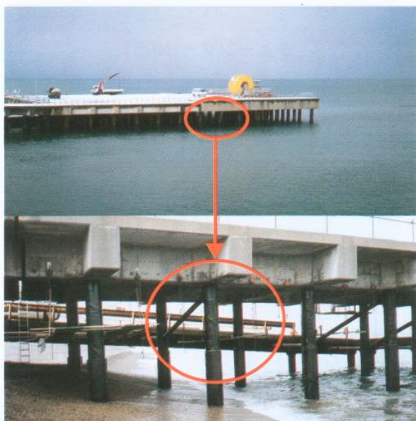
シーバース 支柱の防食(NXL-AZ)
